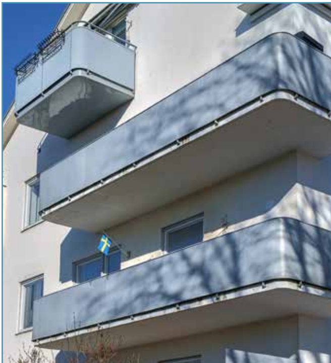
1930-talets balkonger hade ofta släta fronter och sträckte sig kring byggnadens hörn.
