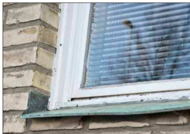
1930-talets flerbostadshus hade ofta uppglasade trapphus (överst). Till fönstrets viktiga detaljer hör också fönsterblecket, här i koppar (underst).
